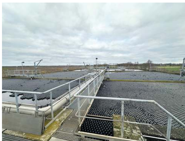
Abb. 3: Alle betroffenen Becken sind mit Schwimmbällen belegt.
