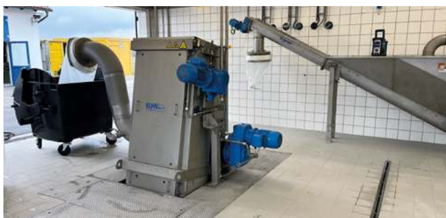
Abb. 4: Das Harkenumlaufsieb ist im neu aufgebauten Gebäude installiert.
